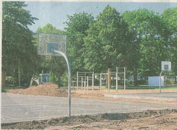
Die Basketball-Felder im Inneren Grüngürtel in Nippes sind schon so gut wie fertig. Foto: Schöneck
