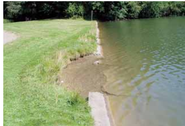
Abb. 124: Schäden am Ufer des Decksteiner Weihers
