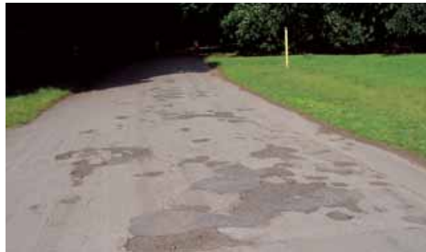
Abb. 60: Beschädigte Asphaltdecke des Hauptweges im westlichen Parkabschnitt
