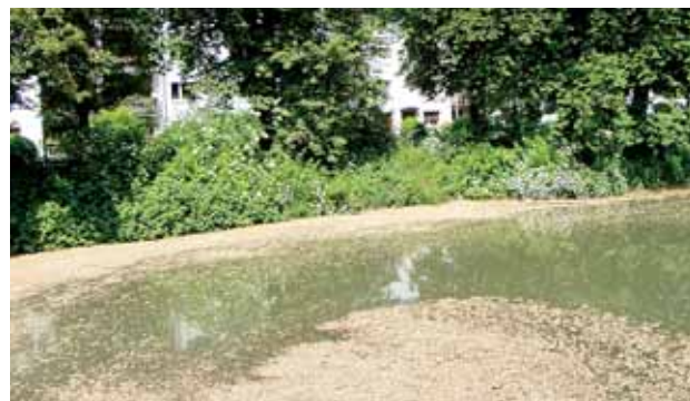
Abb. 33: Von Sträuchern zugewachsene Böschung am Clarenbachkanal
