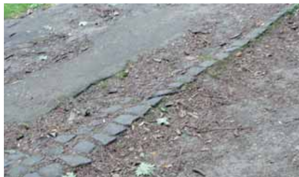
Abb. 62: Von Asphalt überzogene, seitliche Abflussrinne
