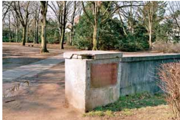
Abb. 31: Beschädigtes Mauerstück am Rautenstrauchkanal
