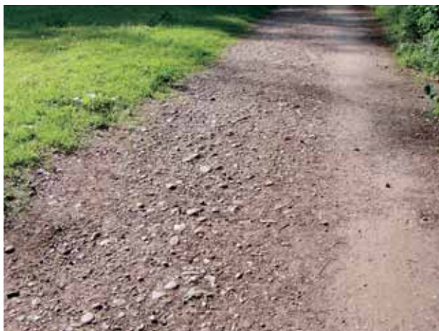
Abb. 63: Zerstörter wassergebundener Nebenweg
