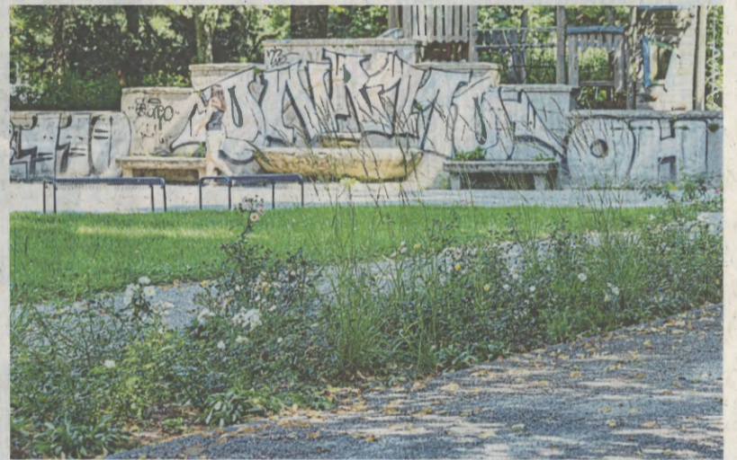
Graffiti-Sprayer haben die Einfassungsmauer verunstaltet.
