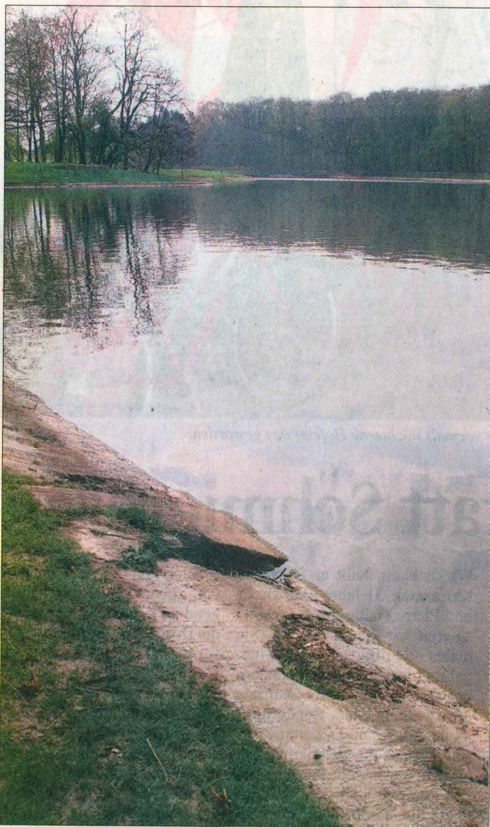
Die Uferböschung am Kalscheurer Weiher wird noch an einigen Stellen ausgebessert. Der Beton ist mit der Zeit bröckelig geworden. BILD: SÜSSER
