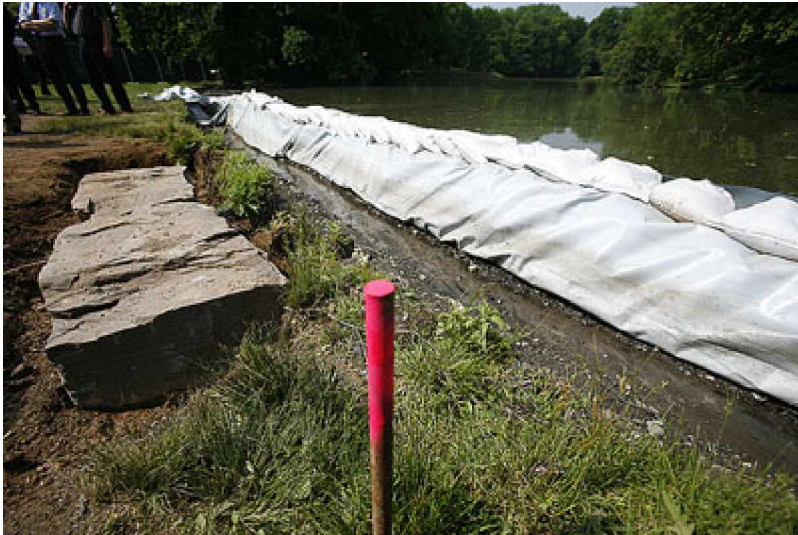
Hier sieht man wie das Wasser des Sees ein wenig von der Baustelle fern gehalten werden muss
